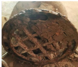
图3 故障潜污泵的进水口检查情况
