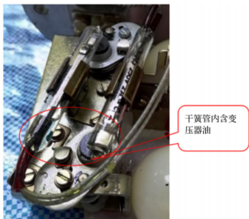
图 3 干簧管内存变压器油图
